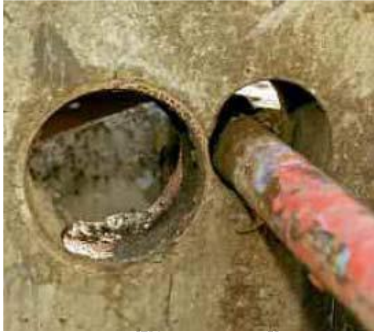
Figura 6: Agujeros en un dique de contención de hormigón para el paso de tuberías. El material sellante se había consumido (Buncefield Major Incident Investigation Board, 2006b).
