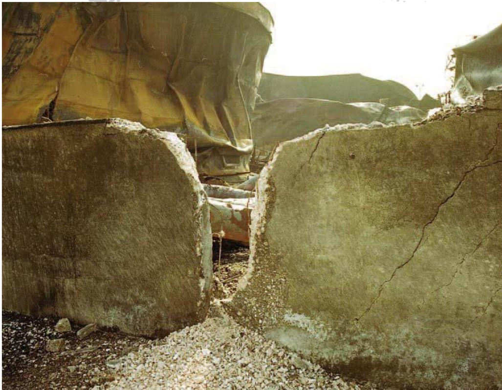
Figura 5: Fractura del muro de hormigón de un dique de contención (Buncefield Major Incident Investigation Board, 2006b).
