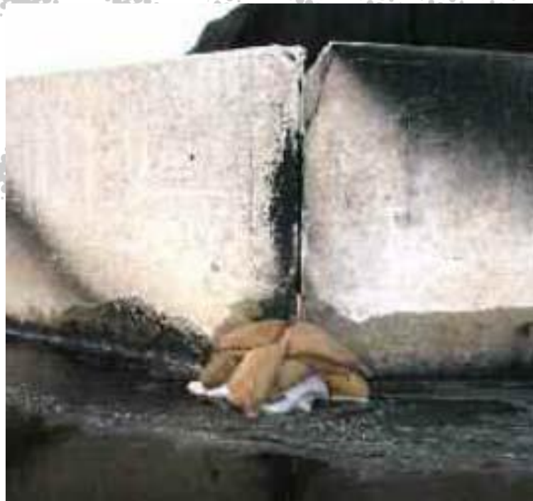
Figura 7: Filtraciones de líquido a través de los diques de contención (Buncefield Major Incident Investigation Board, 2006b).
