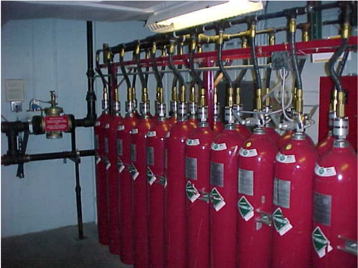
Batería de Cilindros de Gas Licuado de Alta Presión
